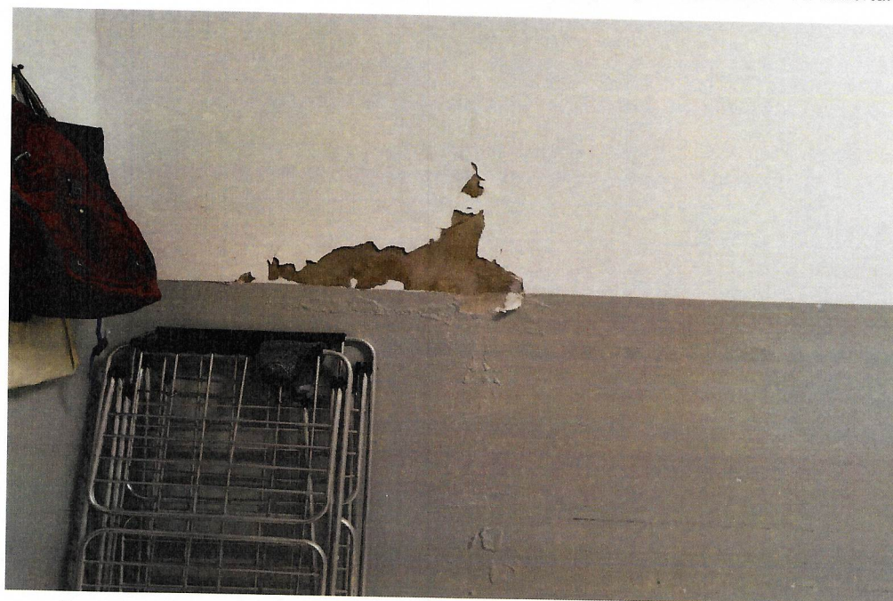
Foto 10 – Desprendimento de pintura e revestimento em parede de ambiente interno.
