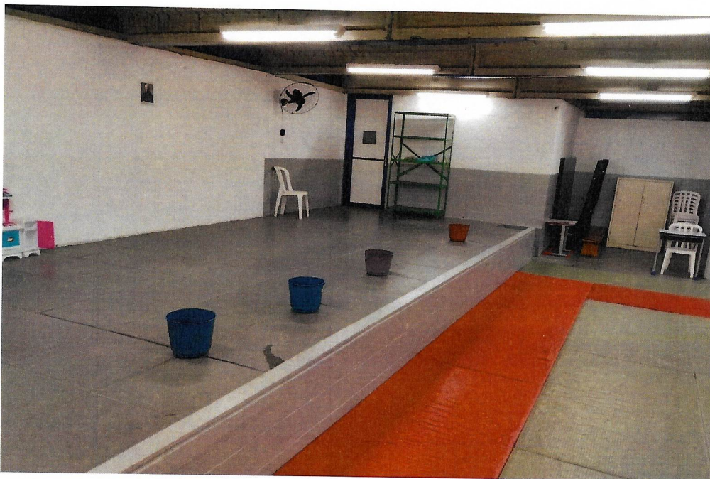
Foto 25 – Recipientes distribuídos pelo ambiente para conter goteiras provenientes da cobertura.
