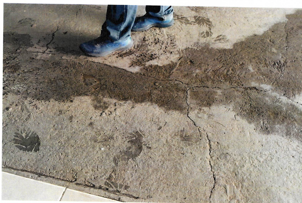
Foto 6 – Piso deteriorado, com fissuras e remendos aparentes.
