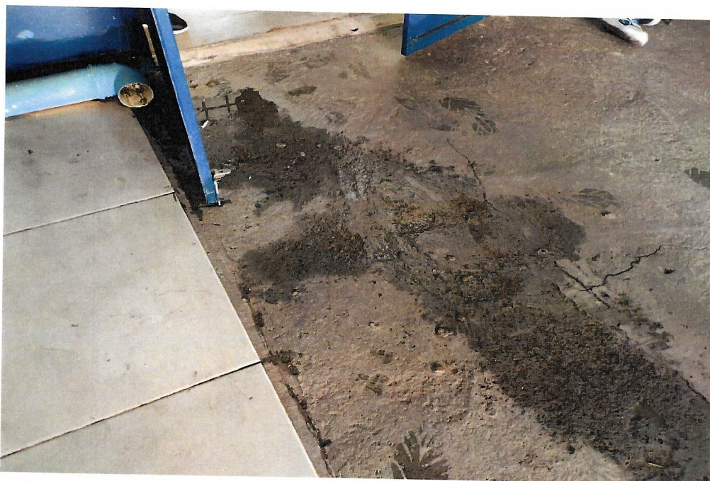
Foto 17 – Piso fissurado e deteriorado junto a acesso e tubulação, com sinais de umidade e remendos.
