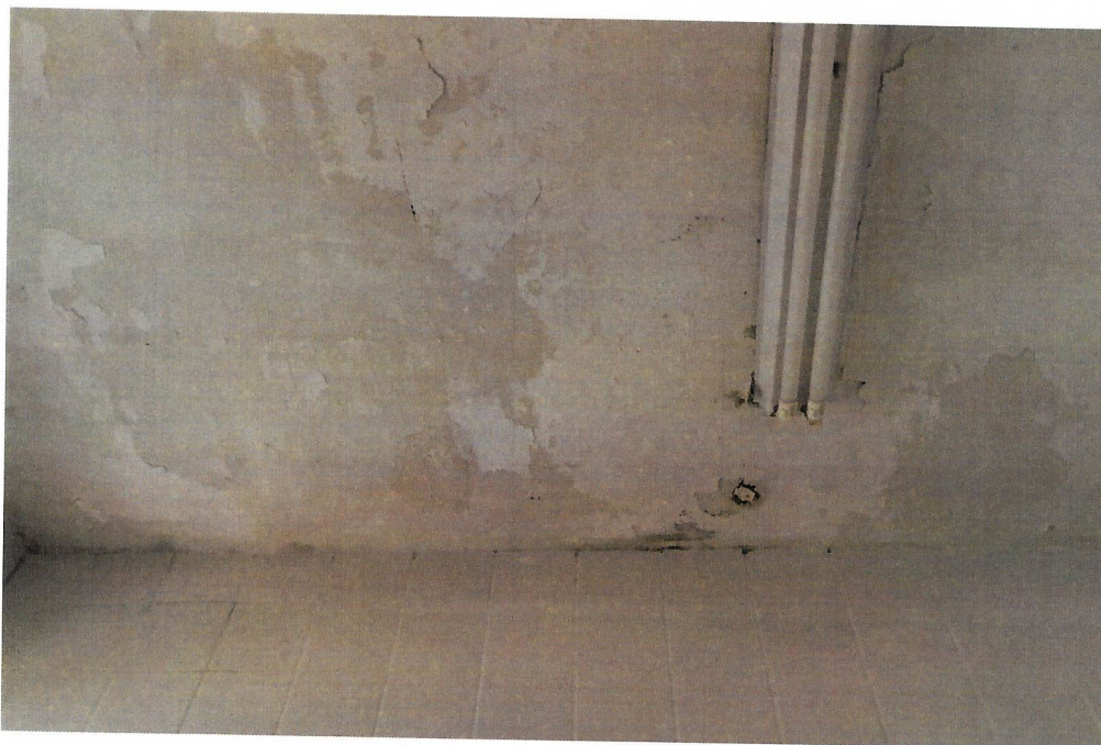
Foto 13 – Descascamento, umidade e deterioração do teto junto às instalações aparentes.
