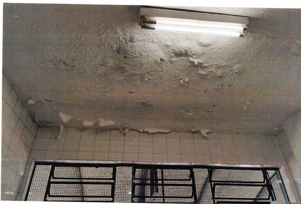
Foto 5 – Umidade, bolhas e desprendimento de pintura no teto.
