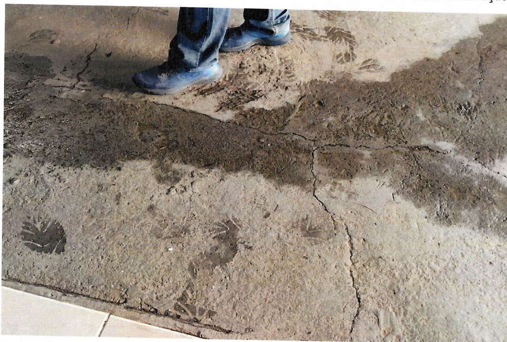
Foto 16 – Registro complementar de piso deteriorado, com fissuras, remendos e desgaste superficial.
