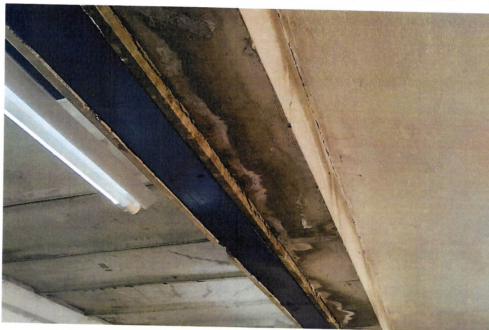
Foto 28 – Deterioração e sinais de umidade em viga e encontro com a cobertura.
