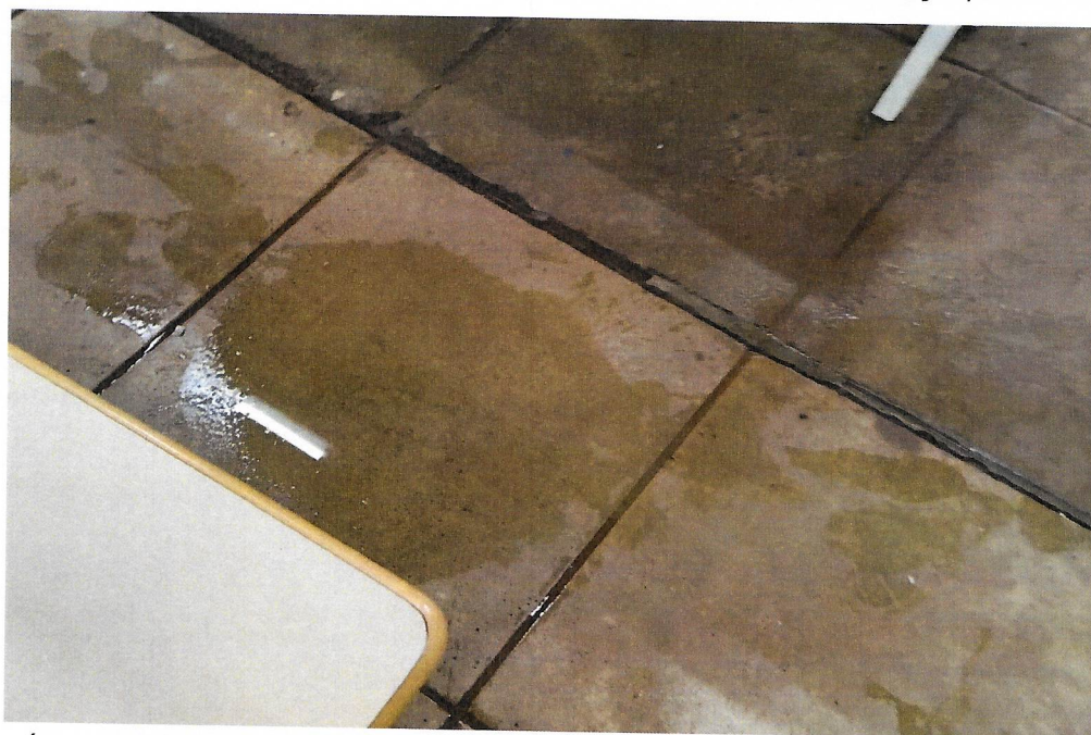
Foto 24 – Água acumulada sobre o piso em ambiente escolar, evidenciando goteira ou infiltração durante o uso do espaço.
