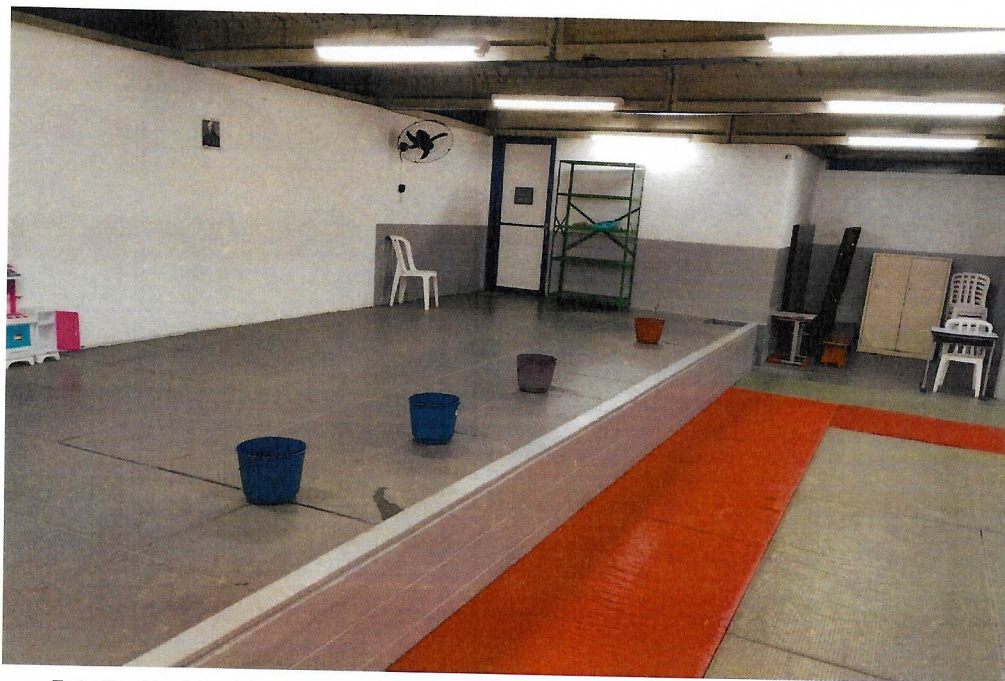
Foto 3 – Recipientes utilizados para contenção de goteiras em ambiente de uso escolar.
