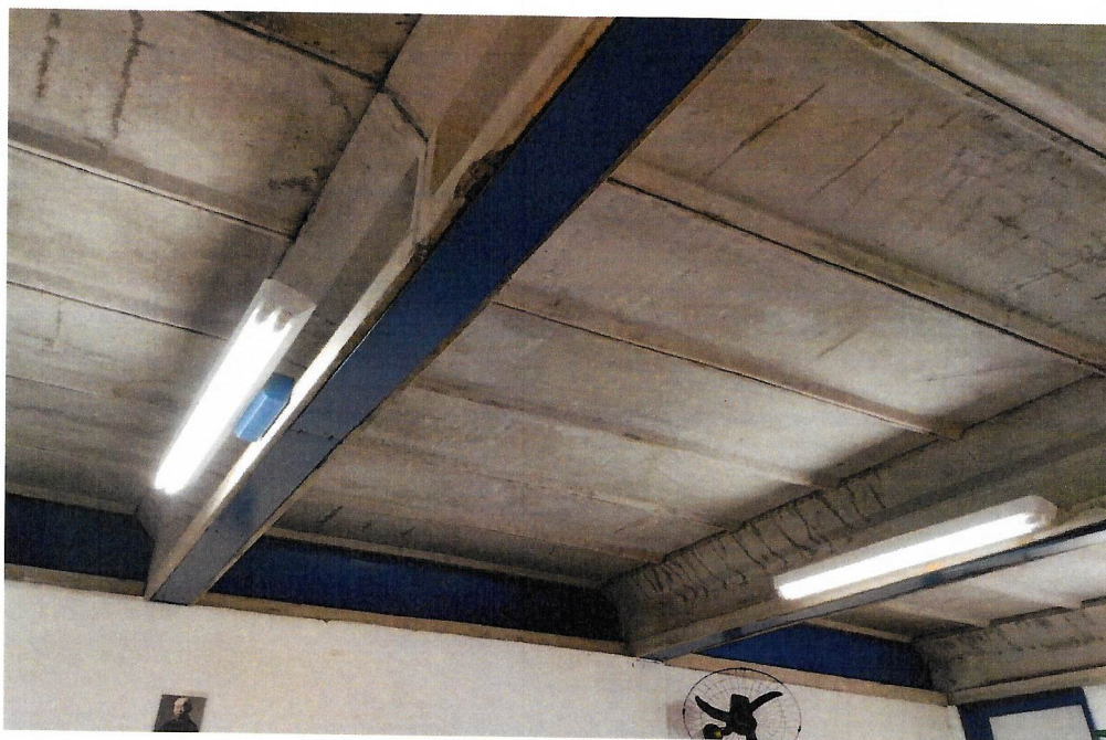
Foto 30 – Cobertura e vigas com manchas, marcas de escorrimento e sinais generalizados de infiltração.
