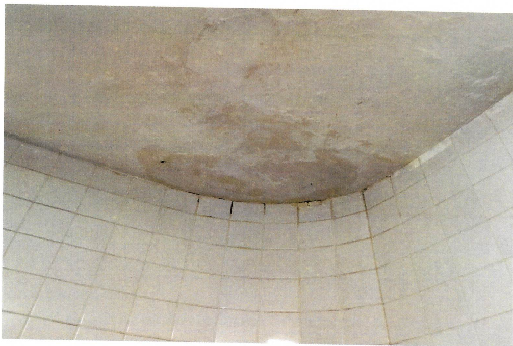
Foto 7 – Manchas de infiltração e umidade no teto de ambiente revestido.
