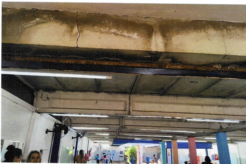
Foto 2 – Umidade e fissuração em elementos superiores e sinais de deterioração junto à cobertura.
