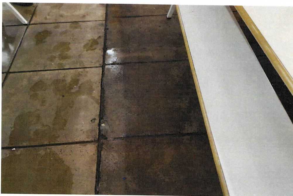
Foto 26 – Piso molhado e com água acumulada junto ao mobiliário, decorrente de infiltração ou gotejamento.
