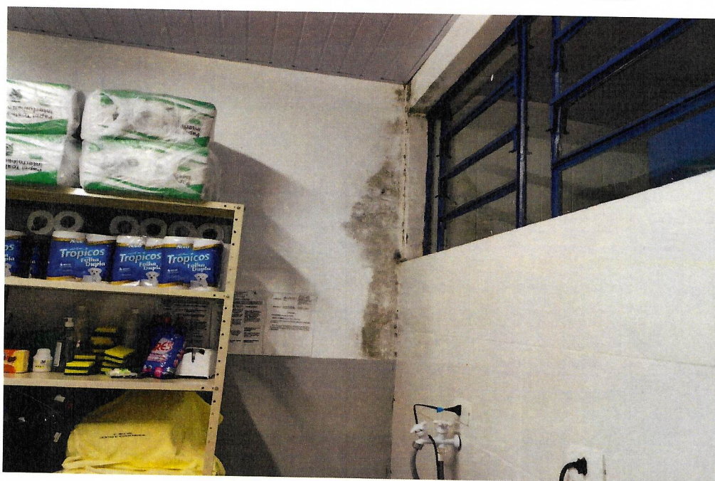
Foto 8 – Umidade e manchas em parede junto a esquadrias e área de armazenamento.
