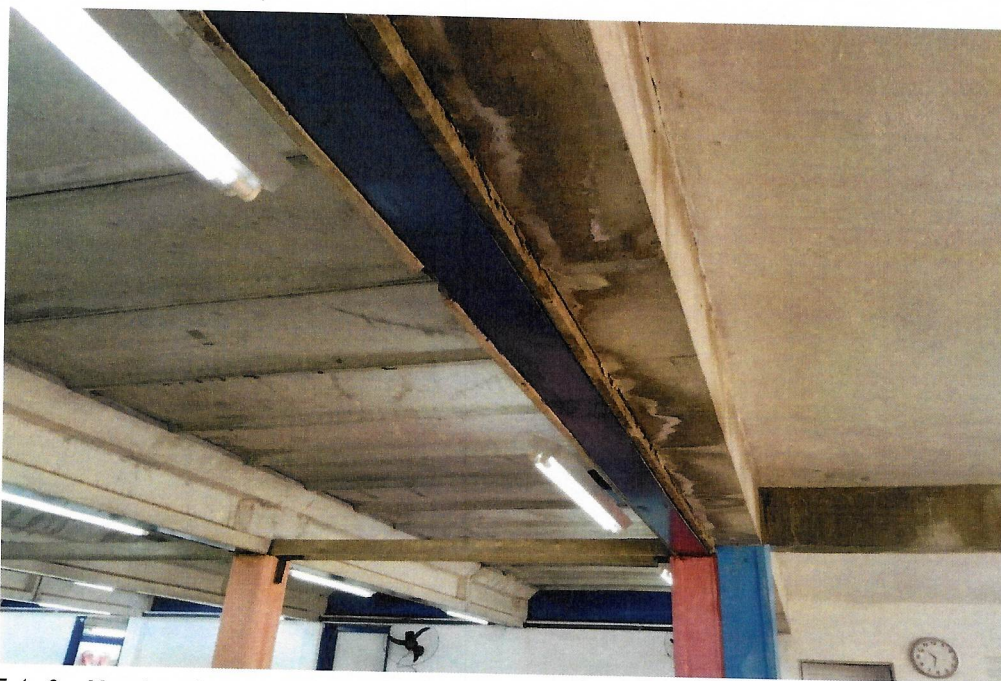
Foto 9 – Manchas de umidade e deterioração aparentes em vigas, lajes e elementos da cobertura.
