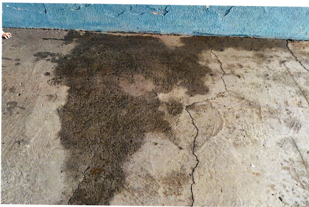
Foto 19 – Fissuras e deterioração do piso junto à parede, com sinais de umidade.
