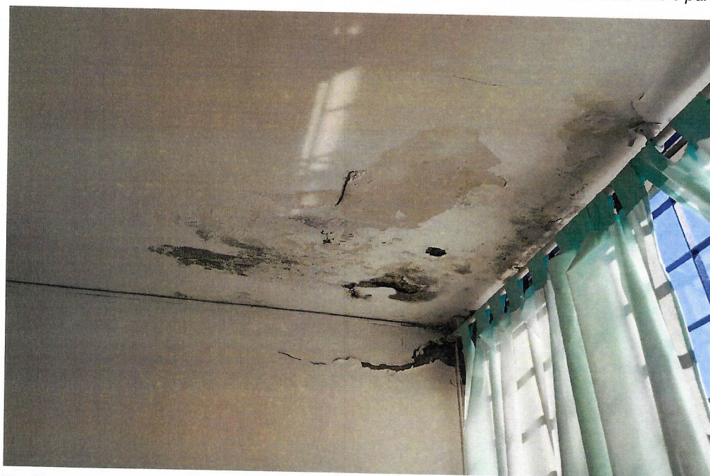
Foto 12 – Registro complementar de infiltração, fissuras e desprendimento de revestimento em teto e parede.
