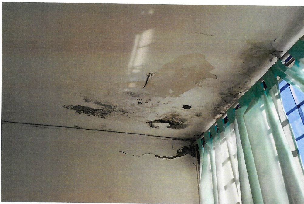
Foto 1 – Infiltração, manchas de umidade, fissuras e desprendimento de revestimento no teto e na parede.
