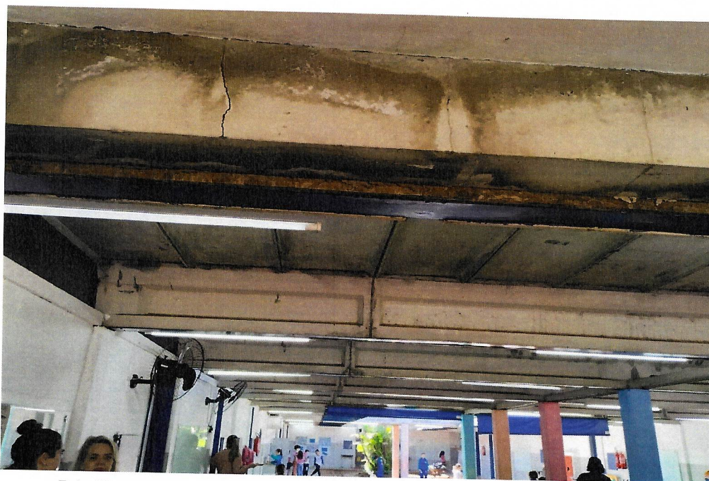
Foto 27 – Viga com fissura, manchas de umidade e deterioração do revestimento.
