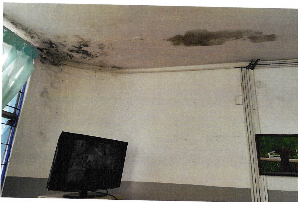
Foto 11 – Infiltração, manchas escuras compatíveis com mofo e fissuras no encontro entre teto e paredes.
