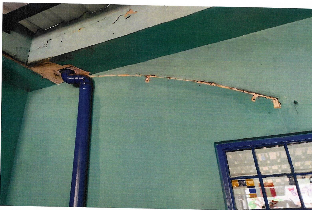
Foto 15 – Fissuras, descascamento de pintura e marcas de escoamento junto à cobertura e tubulação pluvial.
