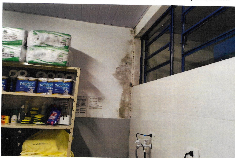
Foto 14 – Registro complementar de umidade e manchas em parede junto a esquadrias e área de armazenamento.
